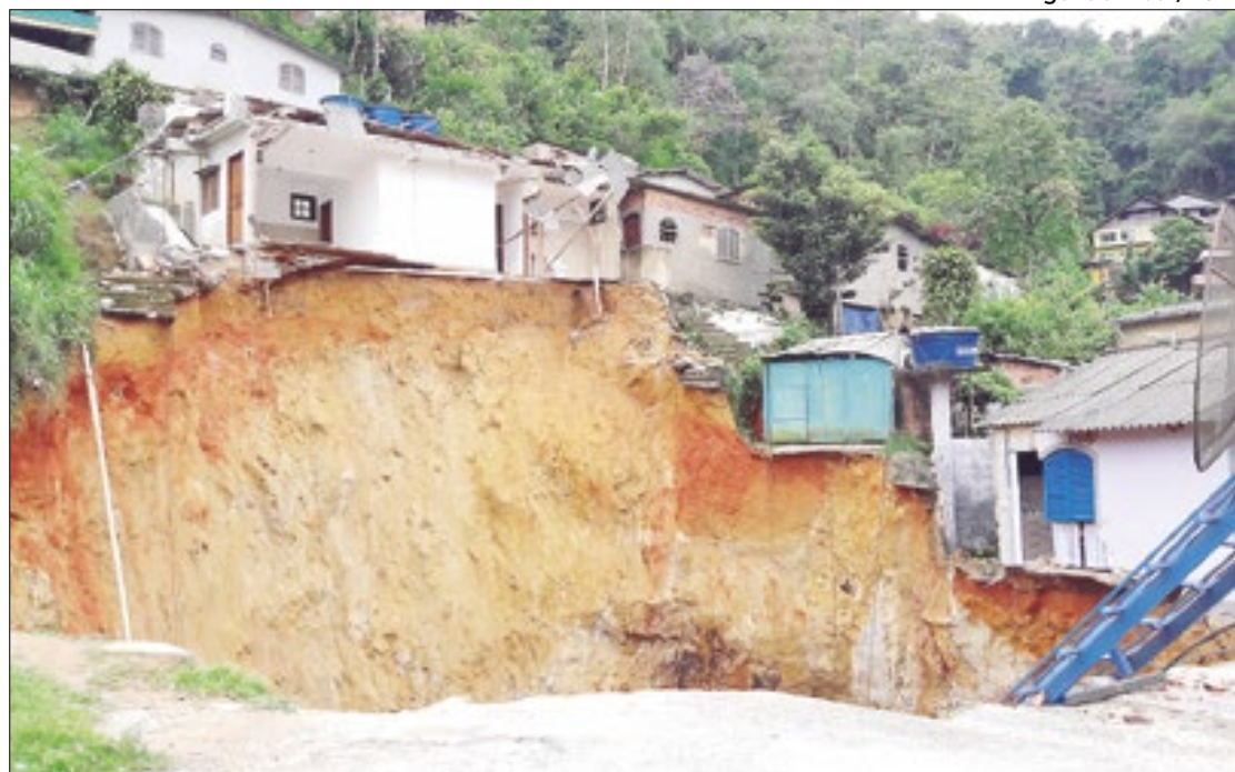
Visão da subsidência, cratera na Nova Subida da Serra
