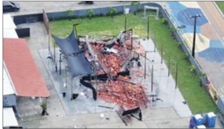
Boate que desabou descumpria normas de segurança
