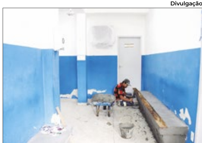
Unidade possui problemas de infiltração e estrutura
