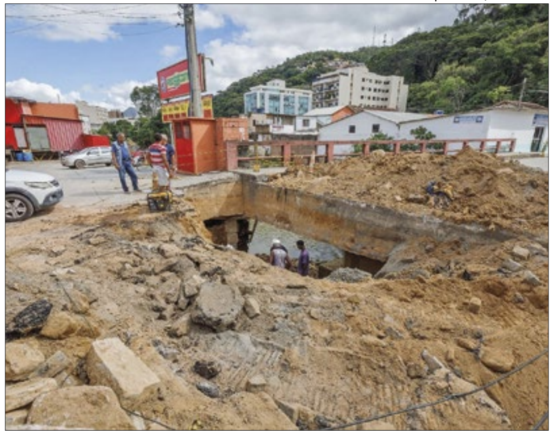
Fundamento na via evidência vulnerabilidade das pistas públicas
