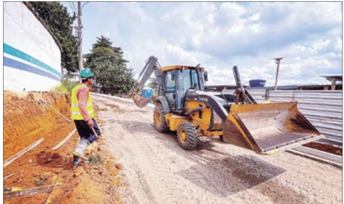
Máquinas e operários estão em ritmo acelerado com as obras na região
