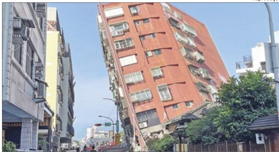
Tremores fizeram prédios desabarem e causaram deslizamentos
