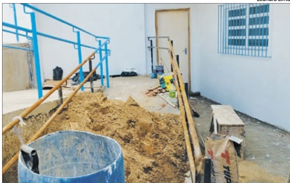
Perto da entrega, entrada do posto de Saúde Sargento Boening com canteiro de obras
