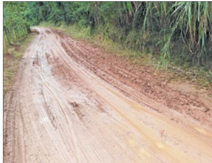
Rua Presbítero Antônio Castor virou lamaçal após chuva
