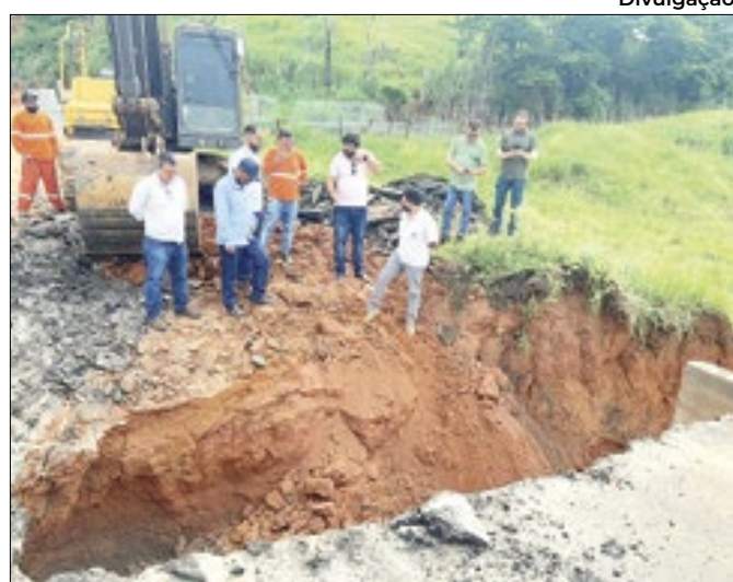
Técnicos estão tentando confirmar danos em pontes
