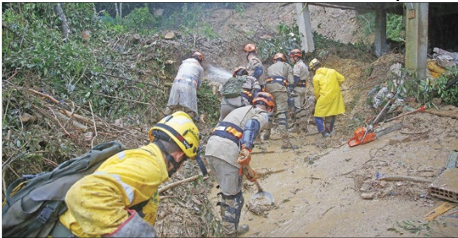
Em Teresópolis, bombeiros resgataram duas vítimas em um desabamento na Comunidade da Coreia
