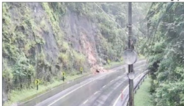
Após queda de barreira, Serra é interditada
