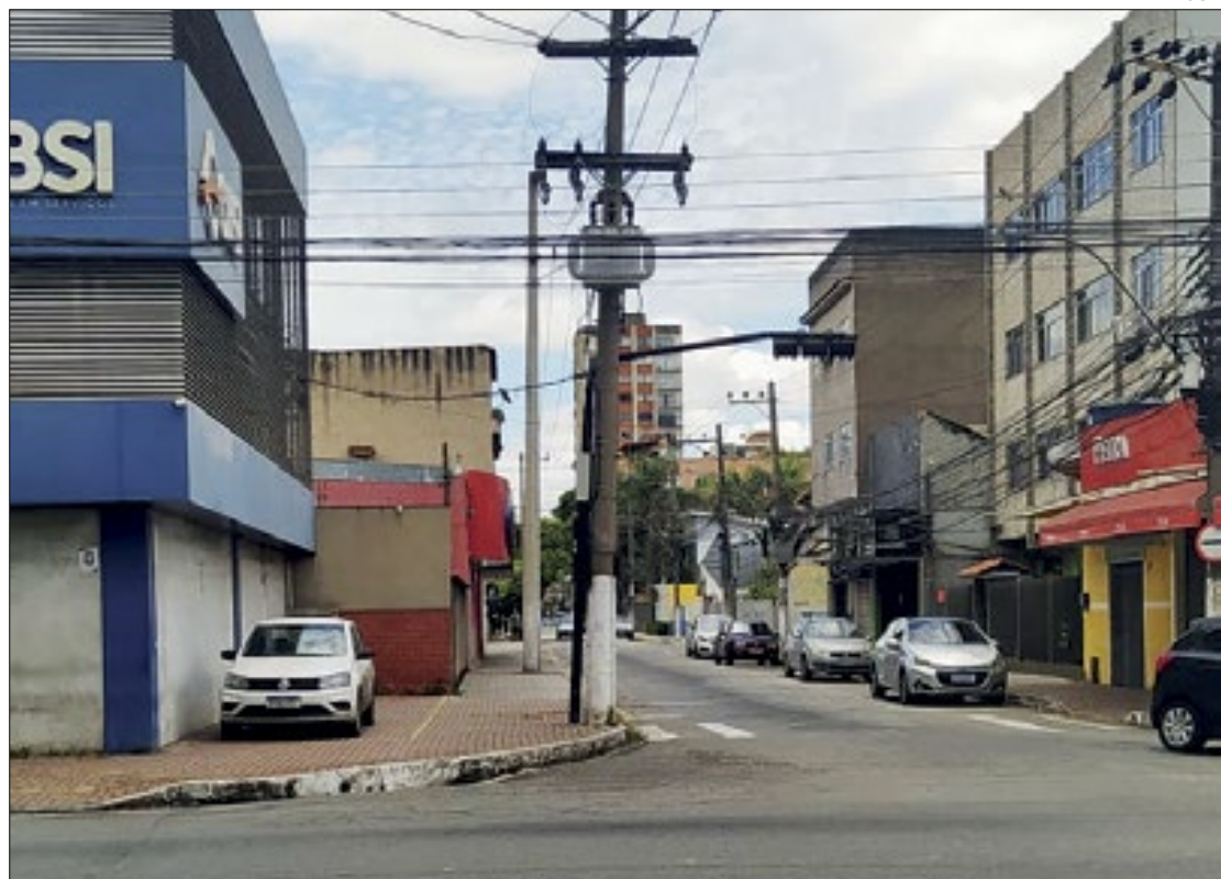
Moradores do bairro Aterrado, em Volta Redonda, temem queda de postes
