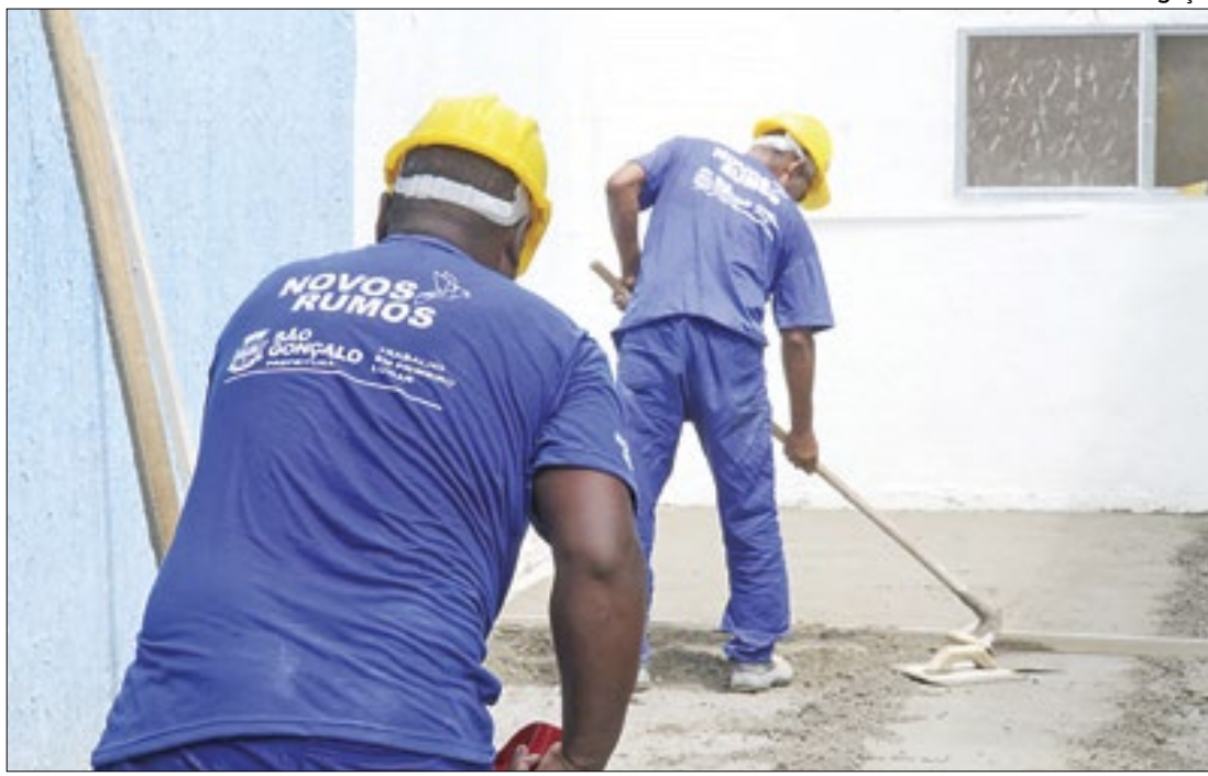
Obras na clínica do Barro Vermelho, em São Gonçalo, seguem em estágio avançado
