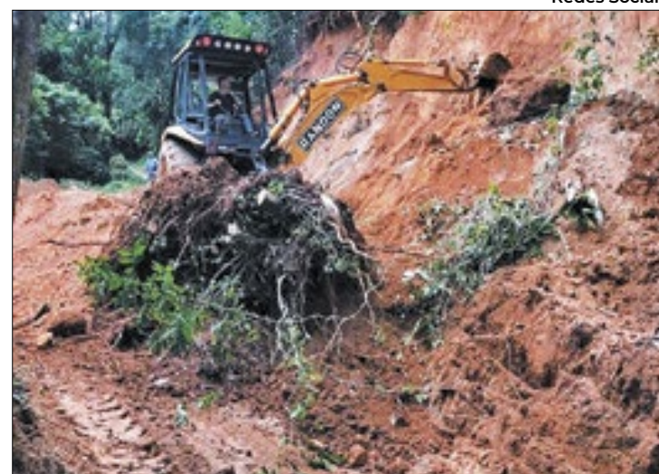
Estrada de Boa Esperança de Lumiar, em Nova Friburgo
