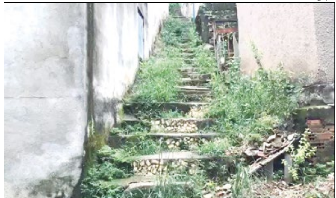
Situação coloca em risco segurança dos moradores do Metalúrgicos, em Barra Mansa
