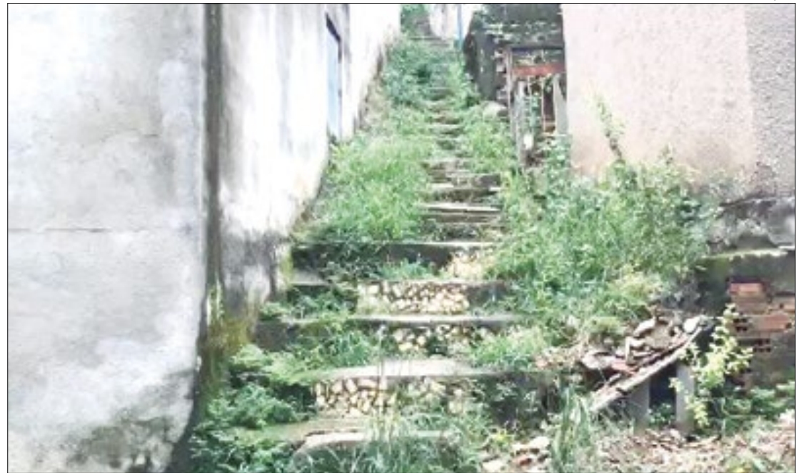
Situação coloca em risco segurança dos moradores do Metalúrgicos, em Barra Mansa
