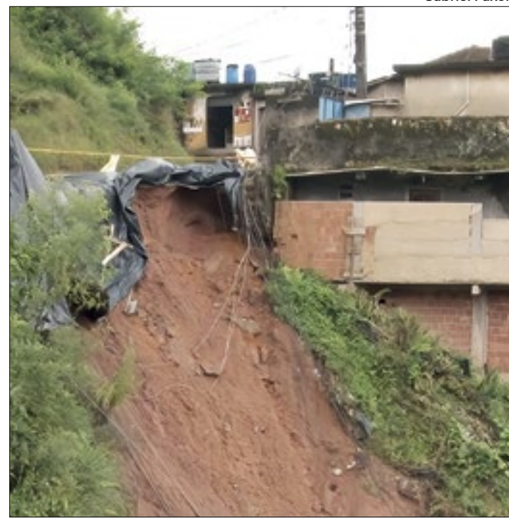
Deslizamento de terra na Rua Nova, em Petrópolis
