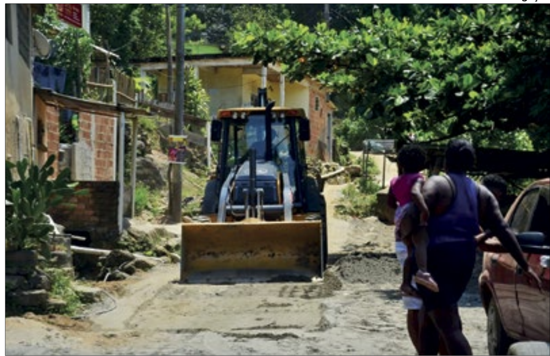
A obra está beneficiando a comunidade, que sofria com transtornos falta de acessibilidade
