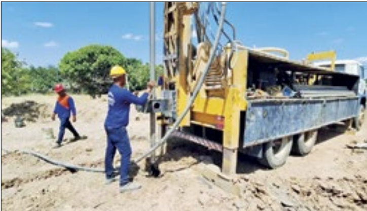
Estruturas concedem 160 mil litros de água por hora
