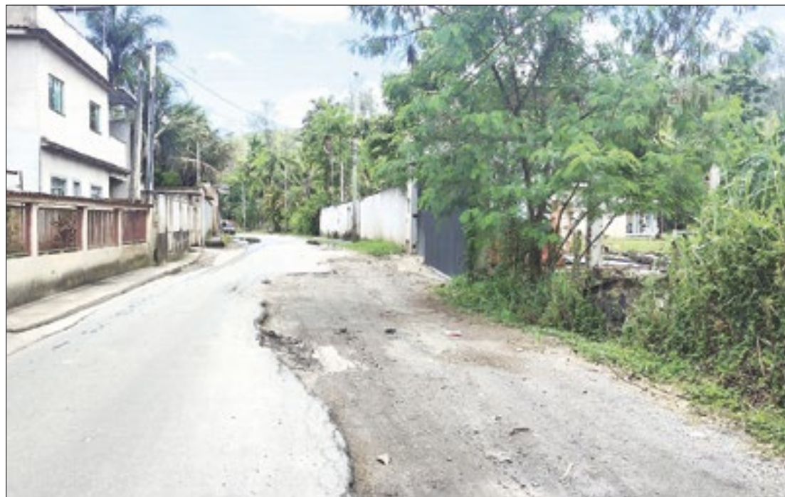
Entre vários problemas, rua possui desnível extenso que dificulta passagem de veículos
