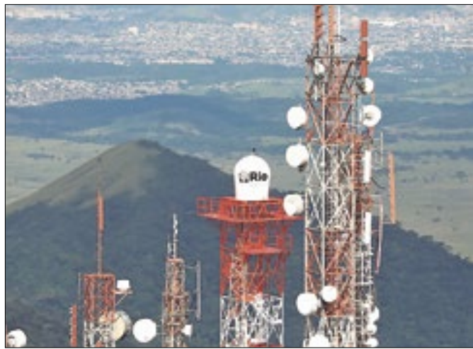
Equipamento foi instalado na Serra do Mendanha
