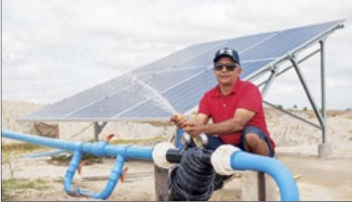
Placas fotovoltaicas possibilitam zero custo com energia
