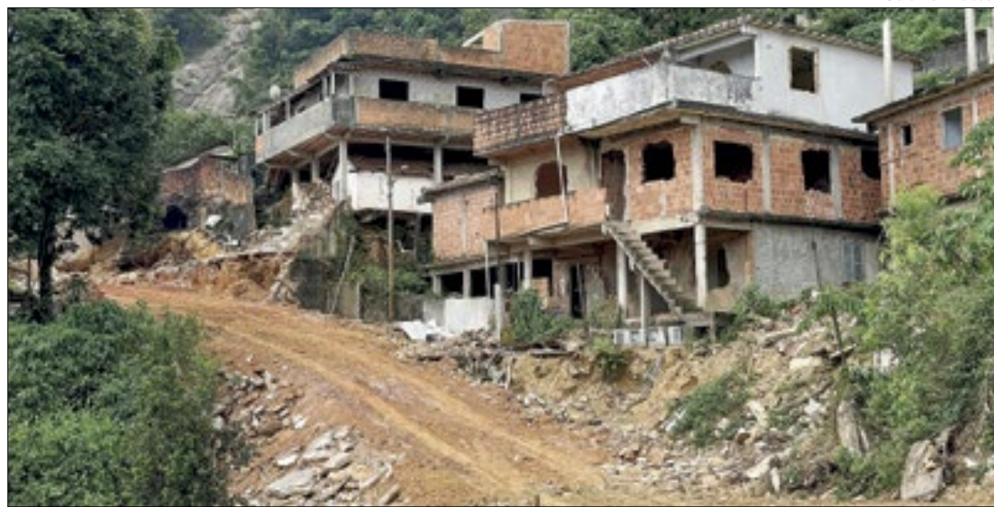
O Morro dos Ferroviários e o Morro da Oficina foram evacuados, ficaram só os escombros
