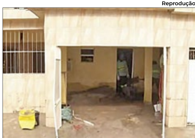
Adutora se rompeu e invadiu casas na região da cidade
