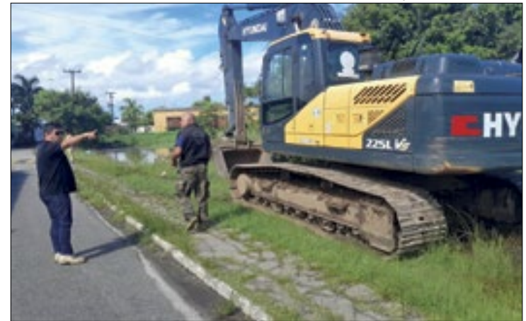
Búzios realizou vistorias em quatro bairros após temporal
