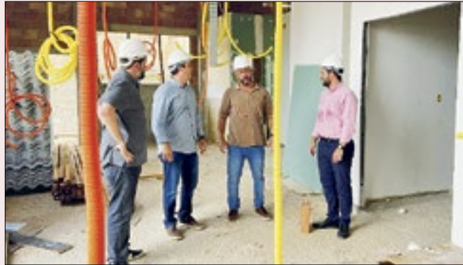
No HFM, a fundação, os pilares e a laje já foram concluídos
