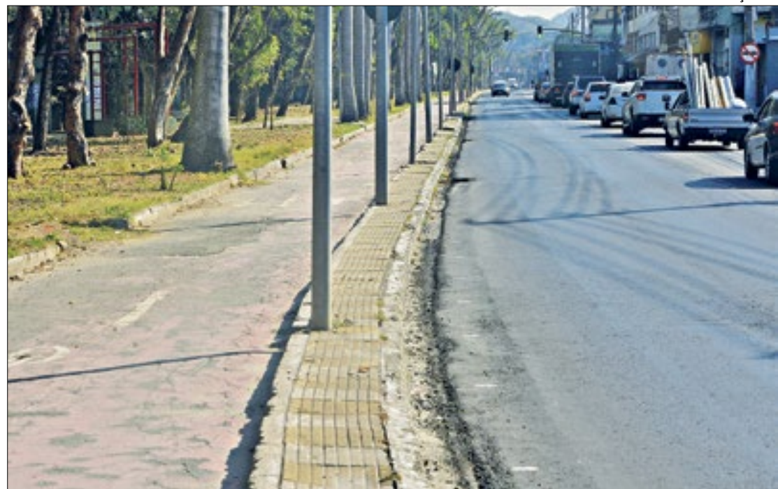
Estrutura da ciclovia da Beira Rio é alvo de reclamações
