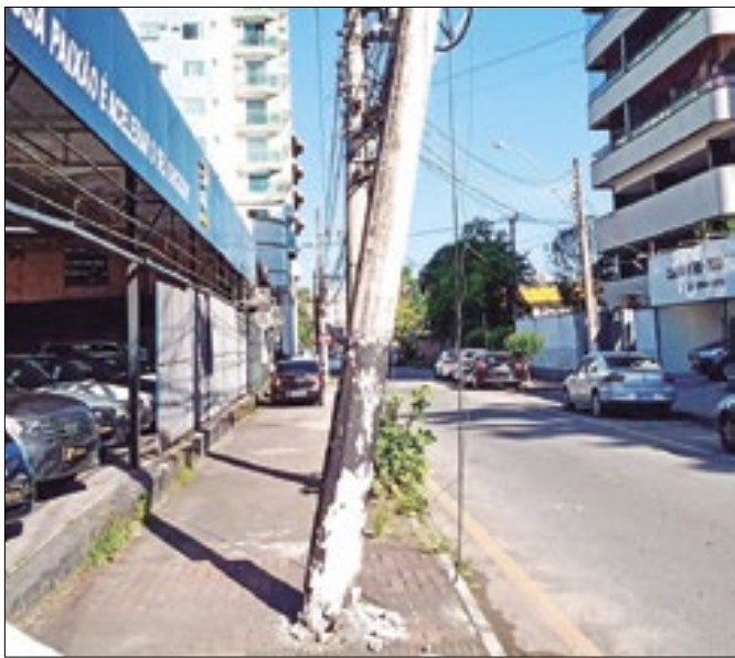
Base do poste ficou danificada após acidente
