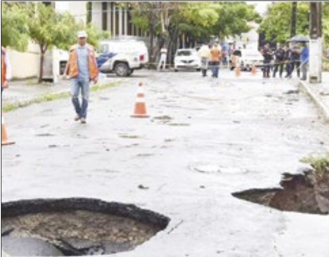
Buracos provocados pelo afundamento do solo
